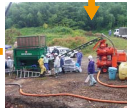
吹付プラント全景
