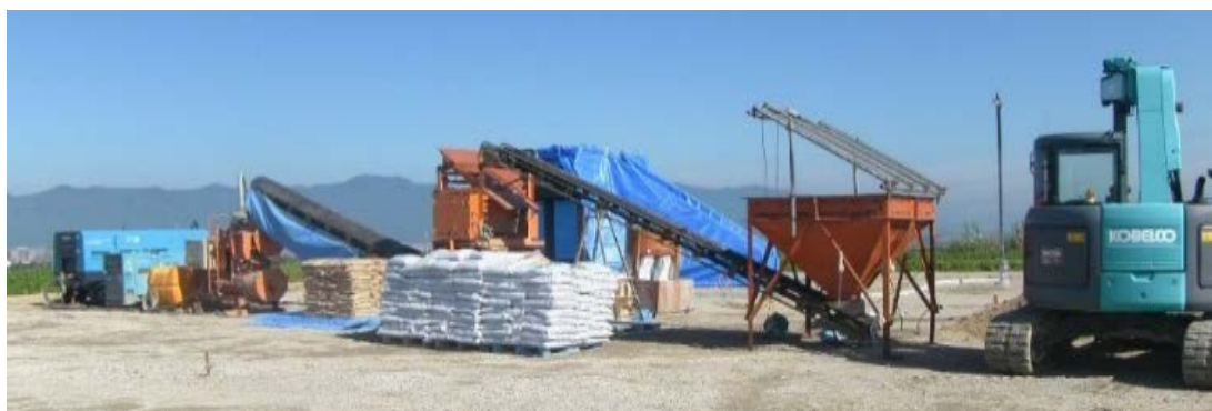
吹付プラント全景
