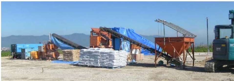
乾式吹付プラント
