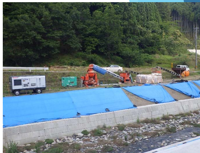
乾式吹付プラント
